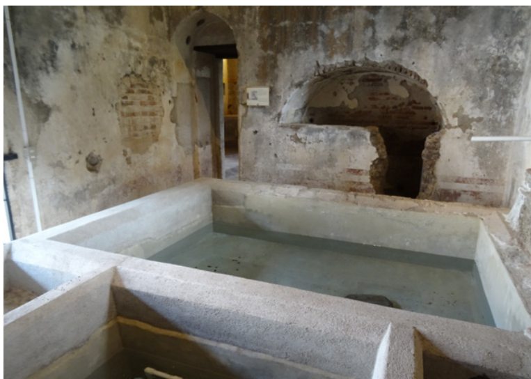
Foto 9. Calentador de agua en el antiguo convento de las Capuchinas Querétaro, México. Fuente: Pastrana (2017).
